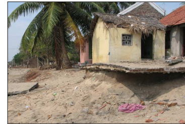
民家周辺の洗掘(2004、インドネシア)
