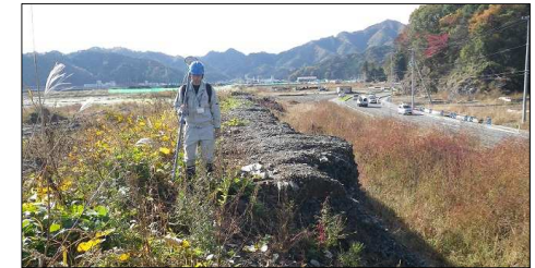
盛土の侵食(2011,岩手県鶴住居)
